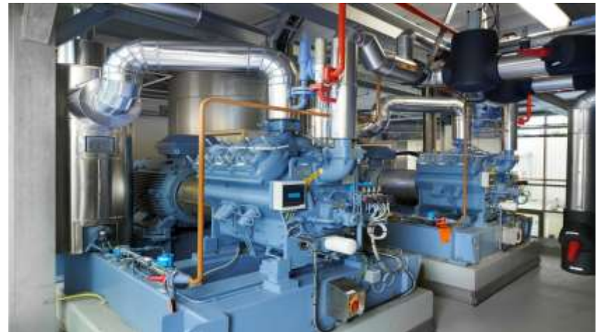
Industriële warmtepomp bij Mars
